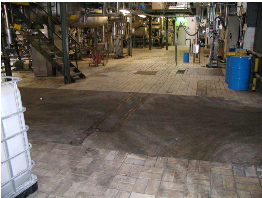
Bild 1: Bodenflächen vor der Sanierung
