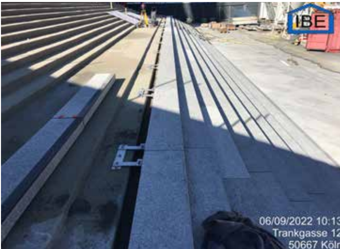
Die Fixierung der Stufen erfolgte mittels einer speziell angefertigten, mehrteiligen Verankerungskonstruktion aus Edelstahl.
